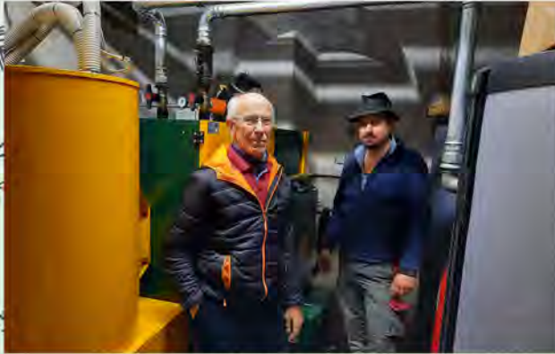
Franz Leiß und Michael Wüchner vor der neuen Pelletsheizung.
