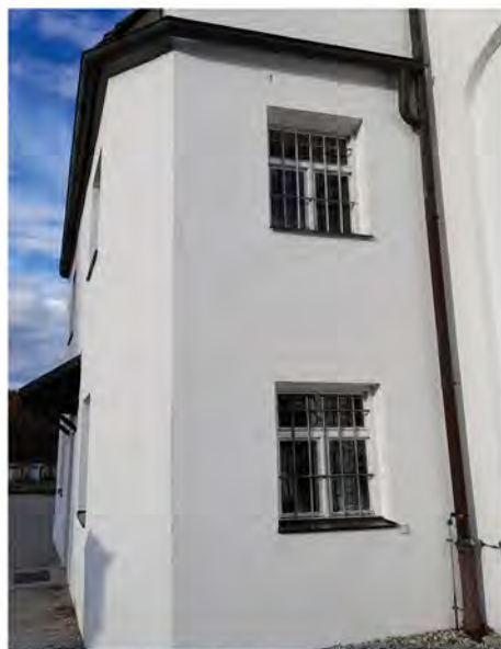
Müssen erneuert werden: Sakristeifenster
